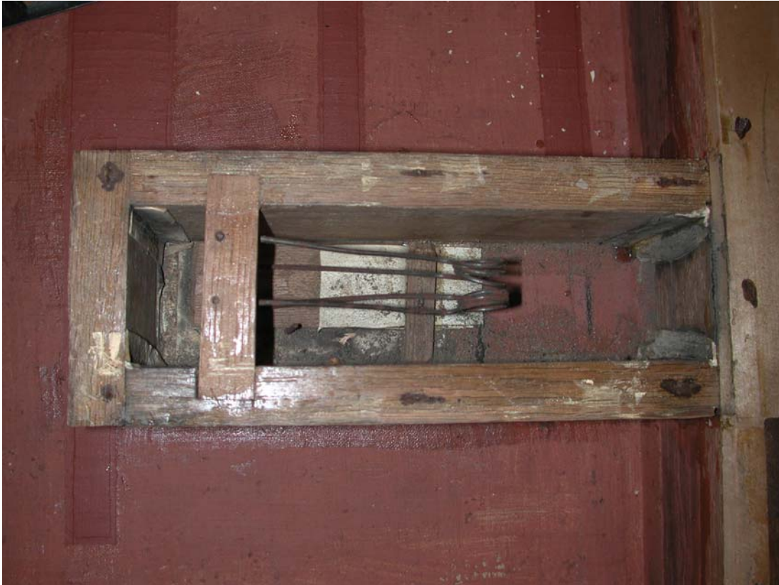
089 Zimbelsternventil vor der Restaurierung im Kanalstumpf unter der Lade
