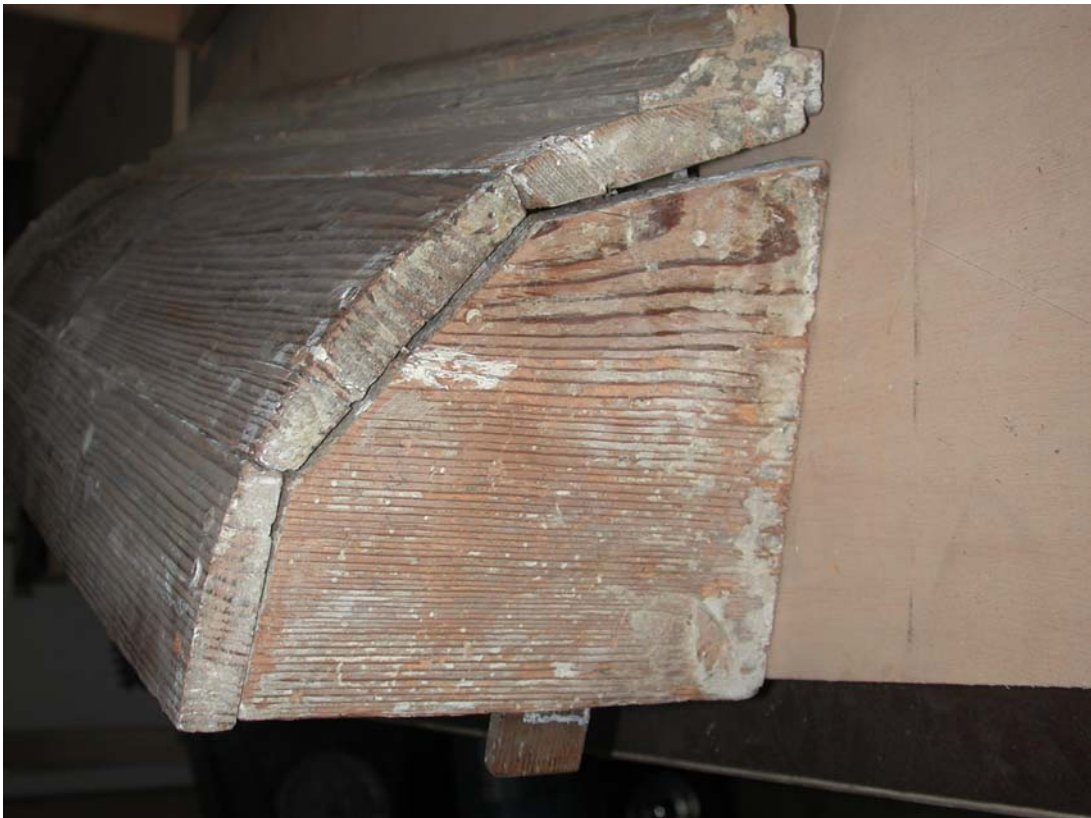
096 - 098 schadhafte Stellen im Gehäuse nach Entfernen der Farbe
