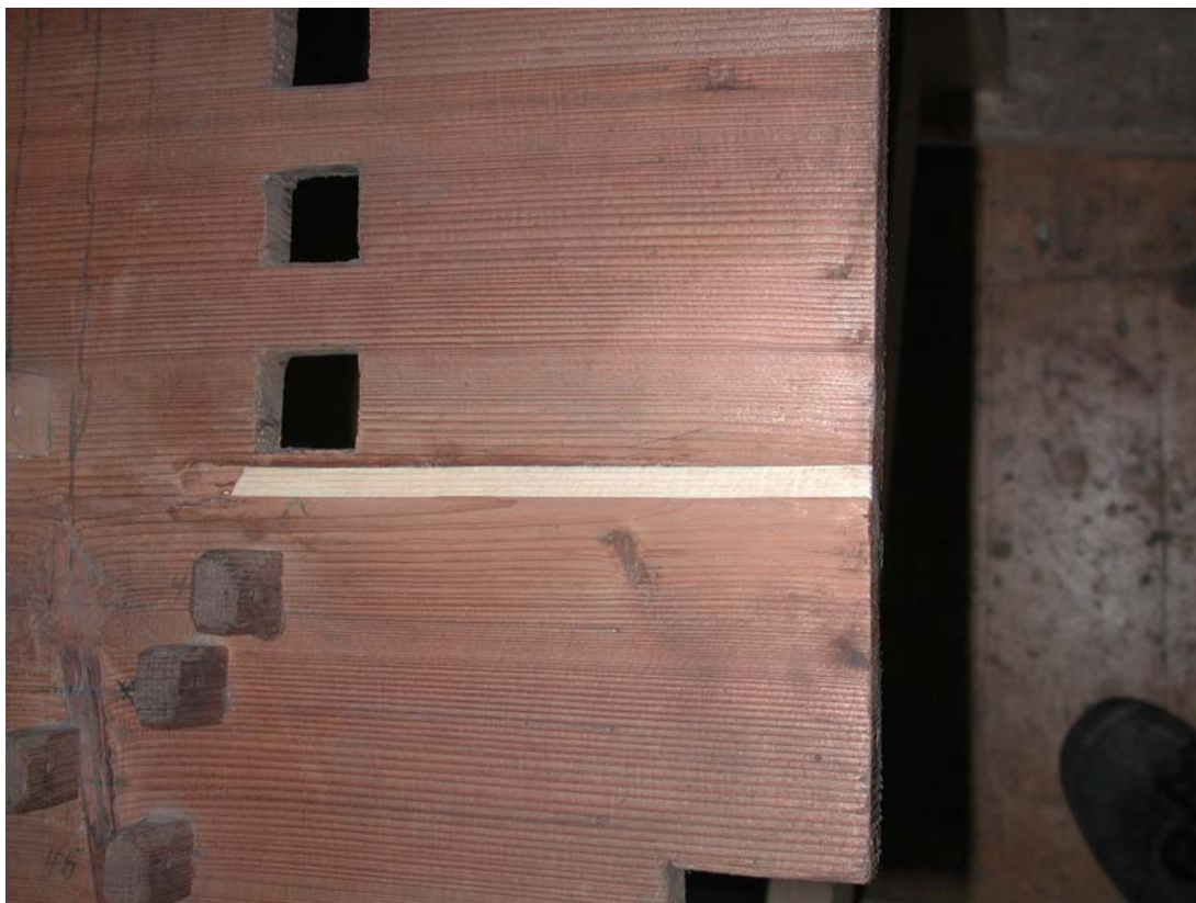
099 ausgespärter Riss im Wellenbrett
